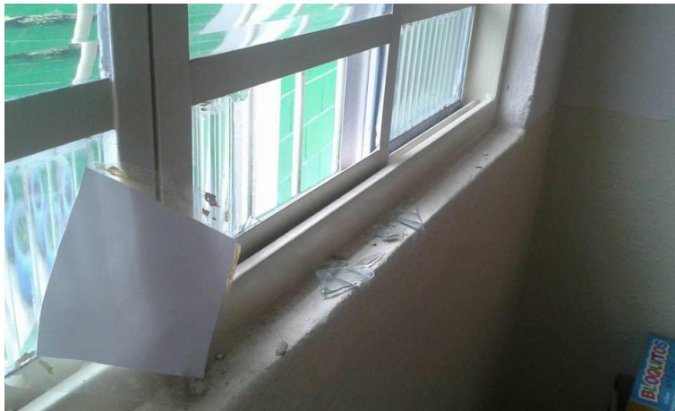
Figura 2 - Deterioração provocada pelo vandalismo
