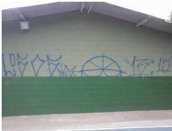
Figura 3 - Deterioração provocada pelo vandalismo
