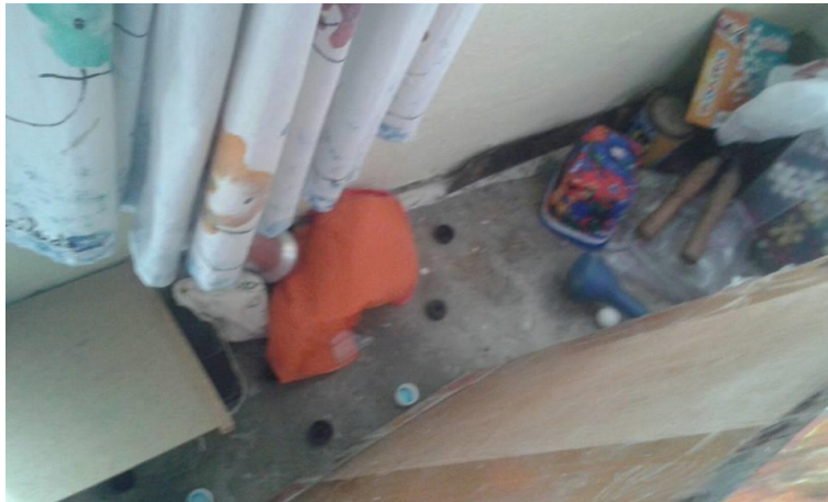
Figura 1 - Deterioração provocada pelo vandalismo
